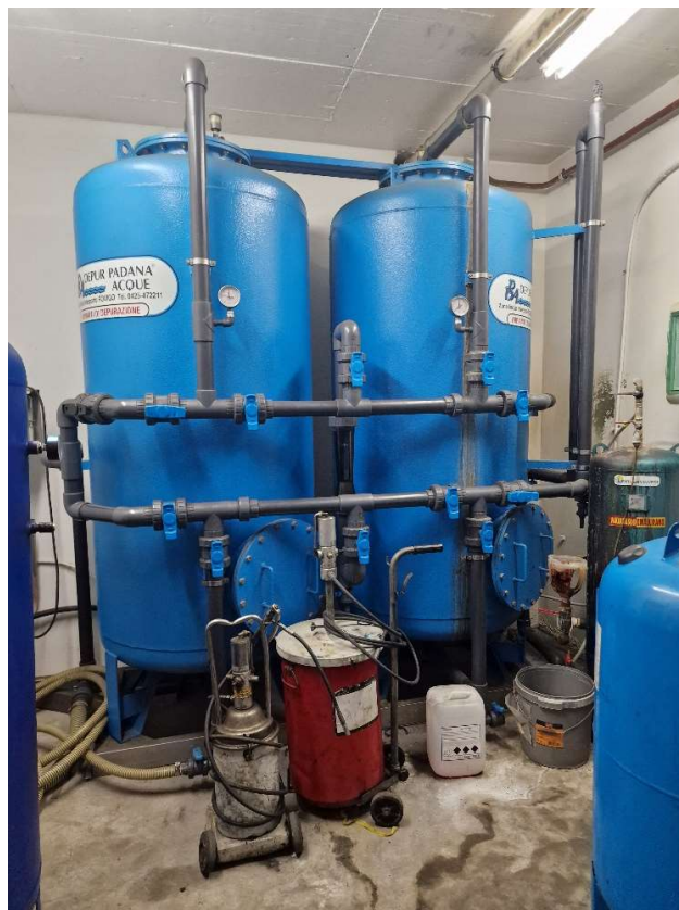
Čistilna naprava za vodo
